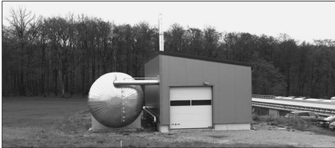
Unsere Aufnahme zeigt die Heizzentrale der Bürger-Energie-Großbeicholzheim e.G.
